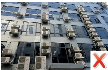
空调机位裸露、杂乱不可取
